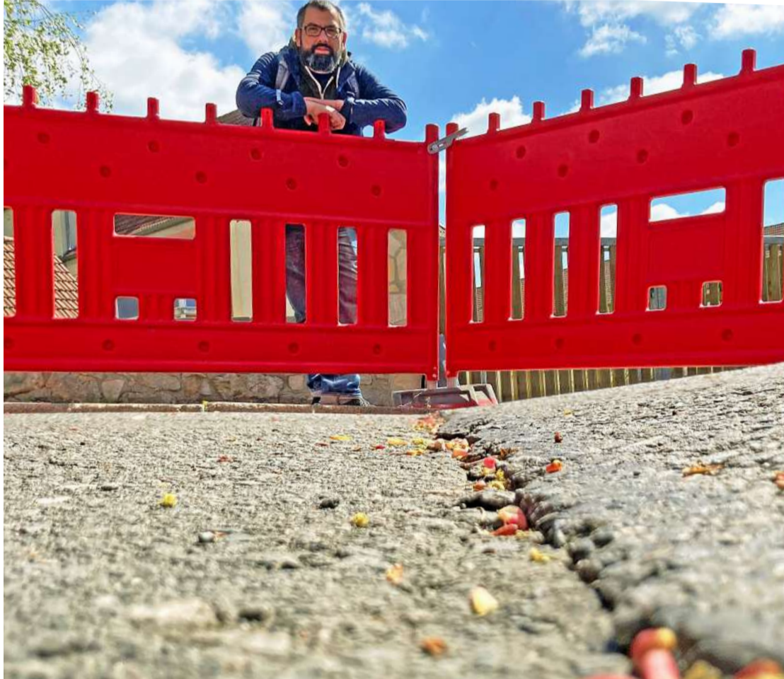
Ortsteilbürgermeister Christoph Vietze an der Schützenhofstraße, die sich nahe der Einmündung Munketal abgesenkt hat. Hier befindet sich der ab heute gesperrte Bereich.
