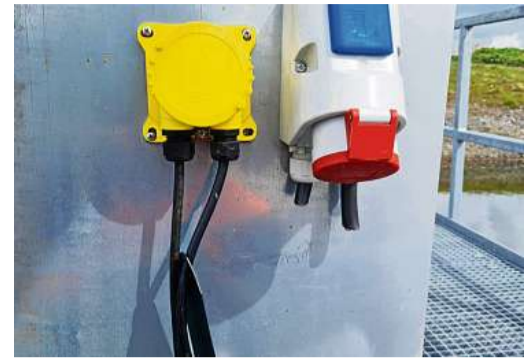
Zuleitung gekappt: Durchschnittenes Starkstromkabel in der Pumpstation im Esperstedter Ried.
