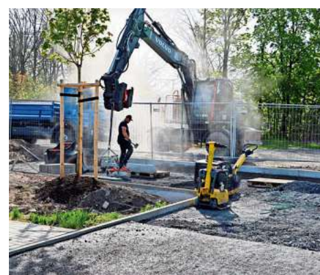
Noch sind Bagger und Bauarbeiter zugange, um dem künftigen Freizeitareal für Kinder und Jugendliche den letzten Feinschliff zu verpassen.
