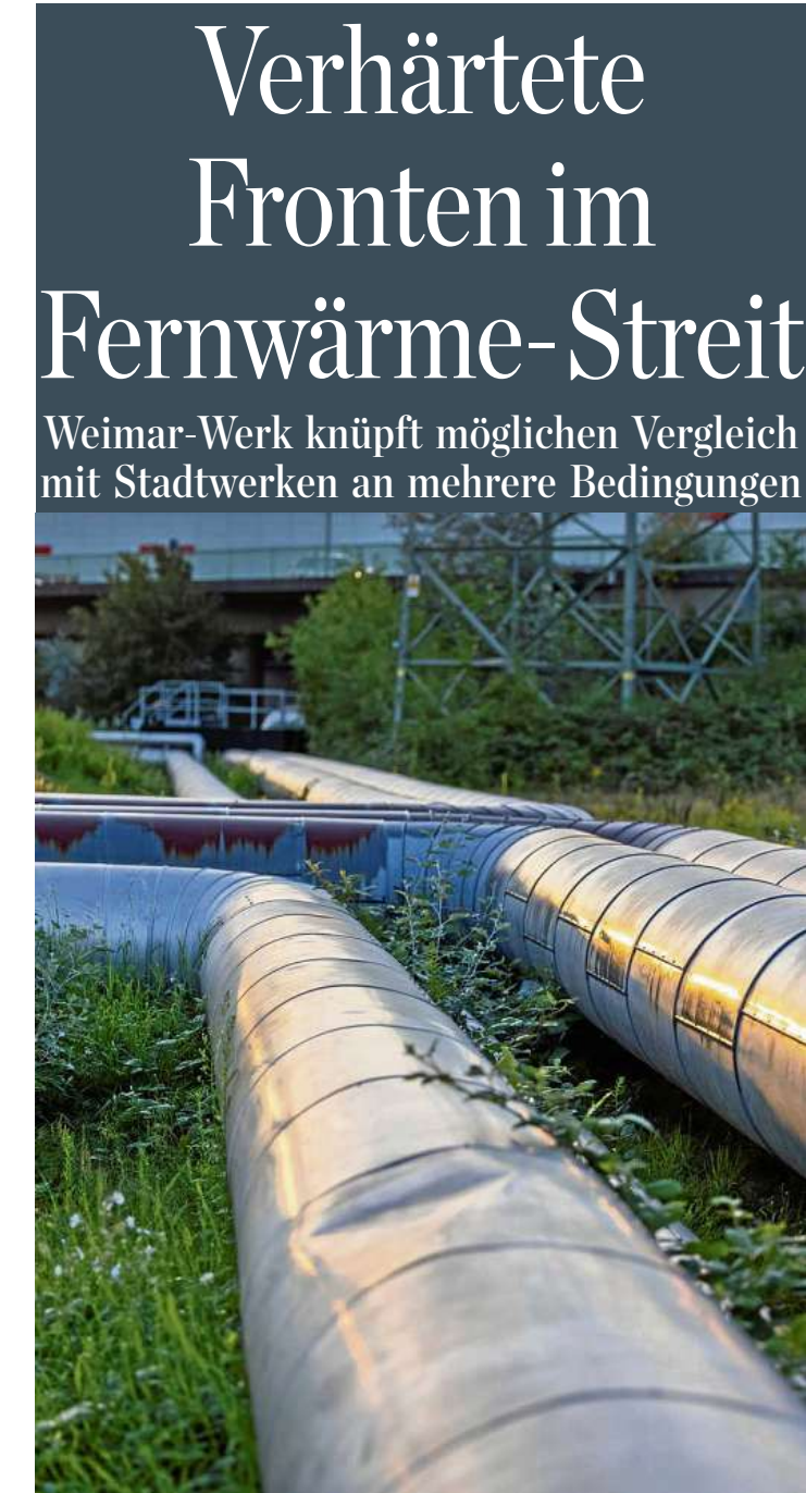
Fernwärme-Rohre laufen durch eine Grünfläche. THOMAS BANNEYER/DPA
