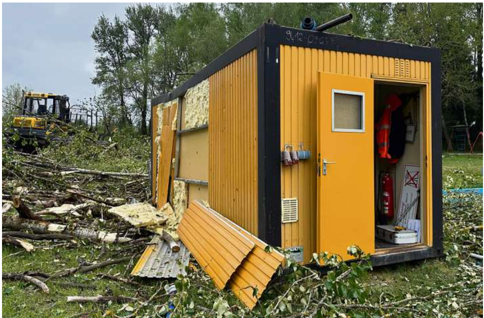
Der Technikcontainer ist außen und innen zerstört.
