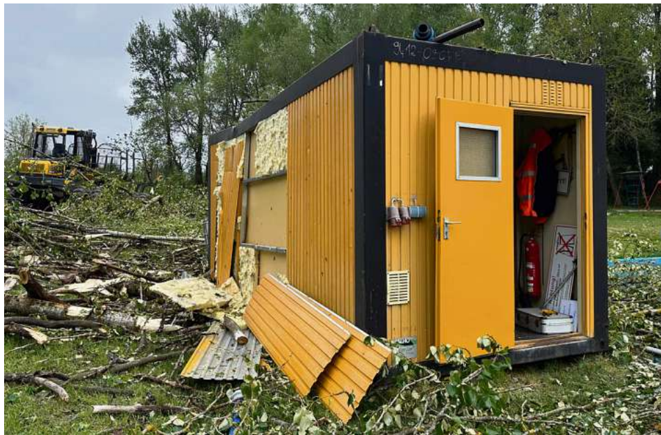
Der Technikcontainer ist außen und innen zerstört.
