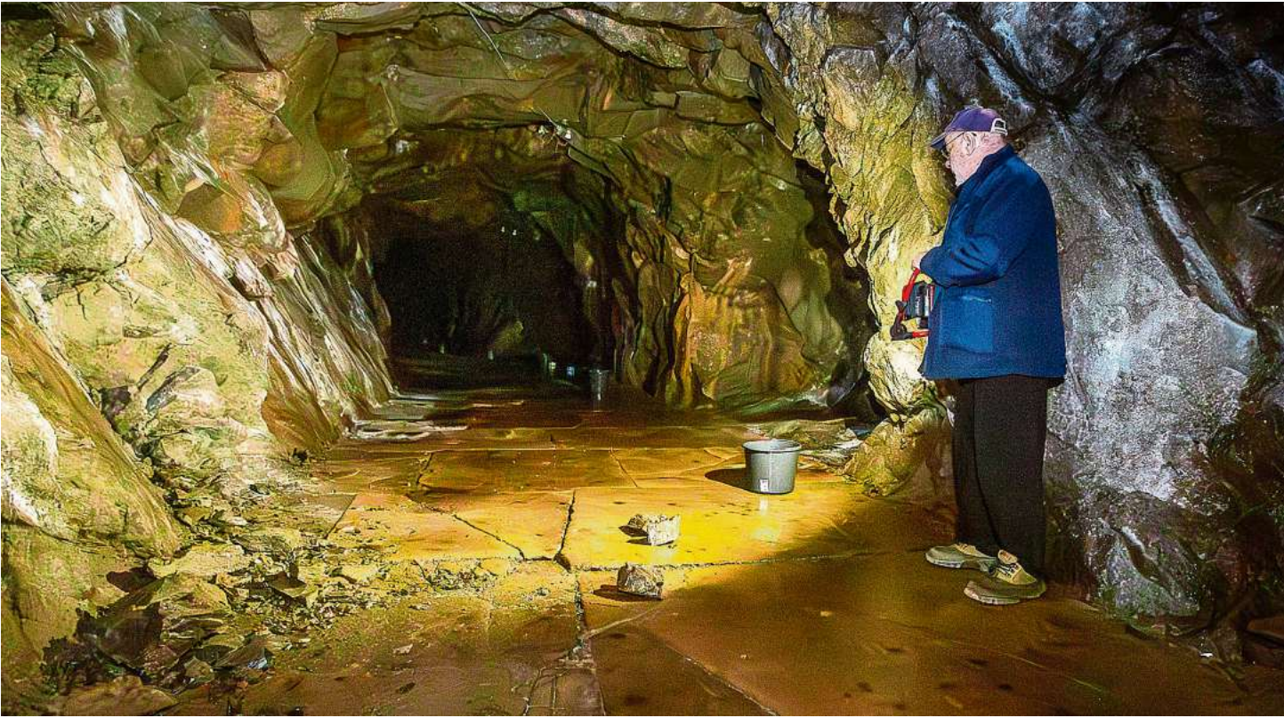
Karl-Heinz Büchel kann nur zusehen, wie der 165 Jahre alte Felsenkeller langsam kaputt geht. Nach jahrelangen Wassereinträgen fallen nun erste Felsbrocken aus der Decke. Weiter hinein traut er sich mittlerweile nur noch mit Bauhelm.
