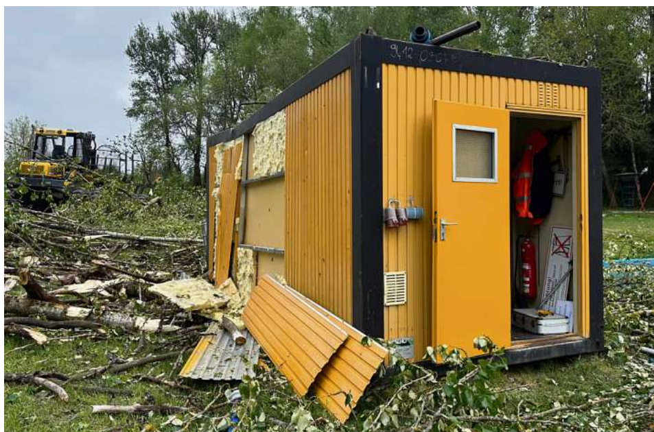
Der Technikcontainer ist außen und innen zerstört.
