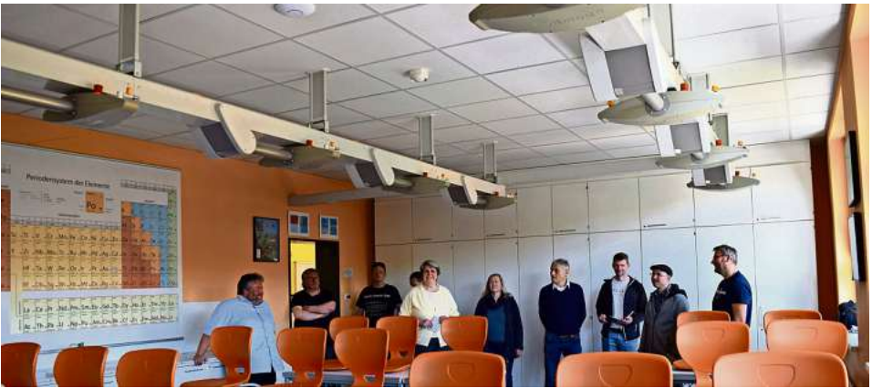
Gemeinschaftsschule Trusetal: Modernes Chemiekabinett. Die Technik ist oben angebracht und lässt im Klassenzimmer mehr Spielraum. Foto: Birgitt Schunk
