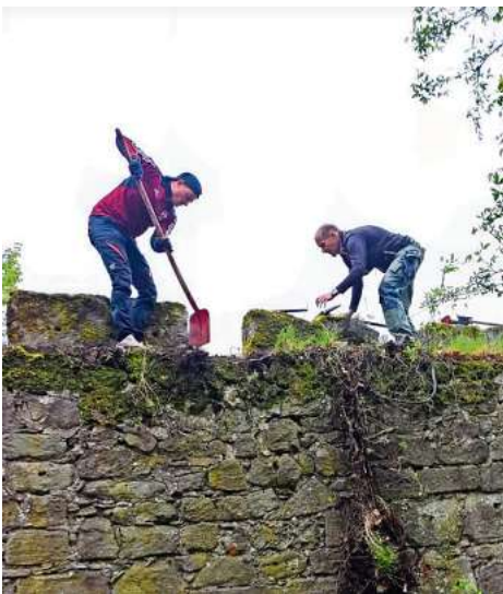
Säuberungsaktion auf der Mauer der Oberlinder Kirche St. Aegidien. Foto: CDU Sonneberg
