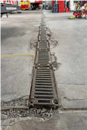
Diese Entwässerungsrinne ist eine Stolperstelle und endet im Nirvana.
