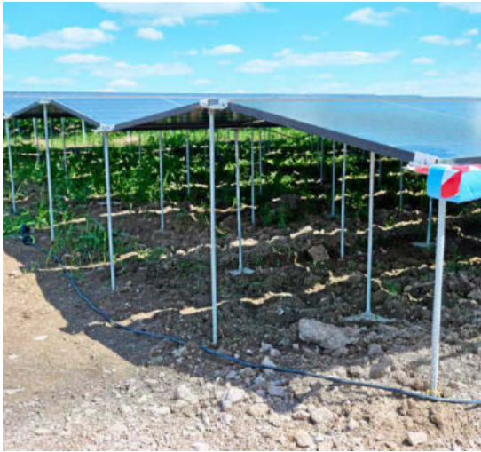
Links: Die rund 9000 Paneele der Anlage werden von mehr als 11.000 etwa 18 Millimeter starken Baustahlstäben getragen.
