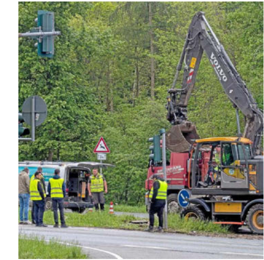
Die Suche nach dem Wo und dem Warum des schweren Wasserschadens in der Arnstädter Chaussee in Erfurt war erfolgreich. MARTIN WICHMANN / WICHMANN TV
