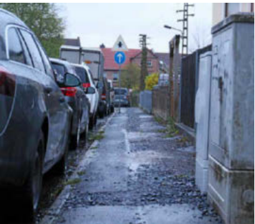
Nach den Glasfaserverlegearbeiten sieht der Bürgersteig nicht so toll aus.
