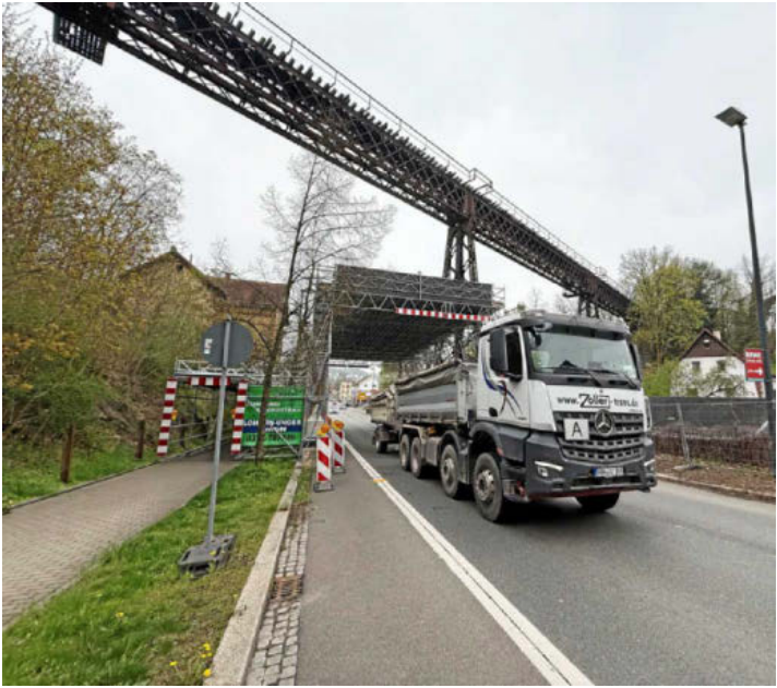
Leser Michael Meier hinterfragt die Sanierung des Viadukts Oschütztal in Weida an der Bundesstraße 92.
