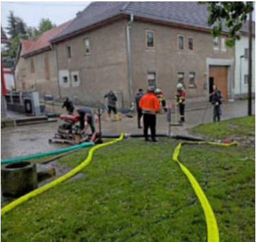
Einsatzkräfte und Helfer pumpten Wasser ab und reinigten die verschlammten Straße.
