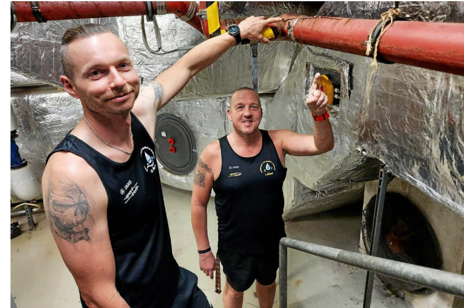
Rettungsschwimmer und Techniker Christian Maskos (links) und der Bäderfachangestellte Jens Michael kennen den Keller des Bades wie ihre Westentasche. Hier stehen sie an korrodierten Rohren, die dringend ersetzt werden müssen.
